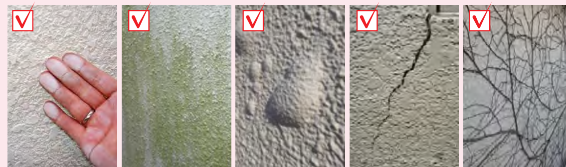
チョーキング現象 外壁のコケ汚れ (モルタル外壁・サイディング外壁) 外壁の膨れ 外壁のヒビ割れ ツタ・植物
